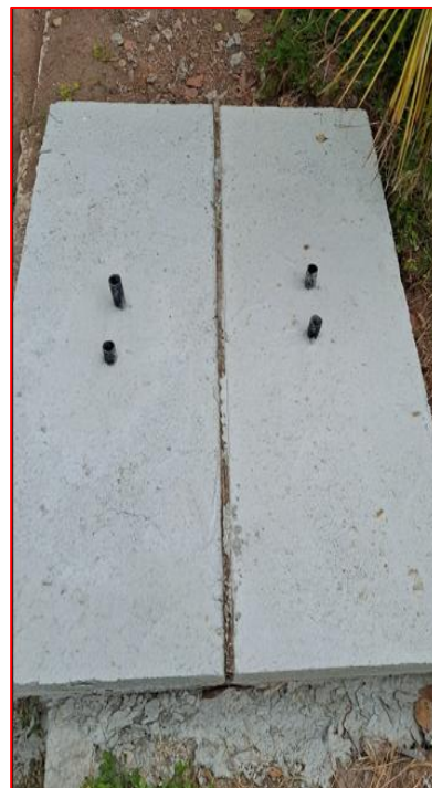
TAMPA DA CAIXA DE DRENAGEM
