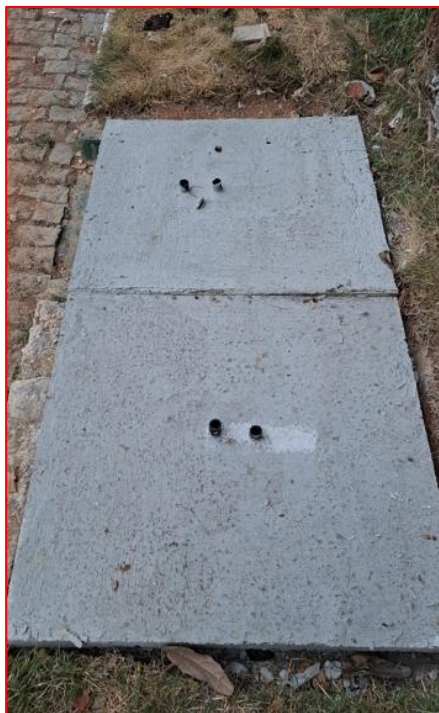
TAMPA DA CAIXA DE DRENAGEM
