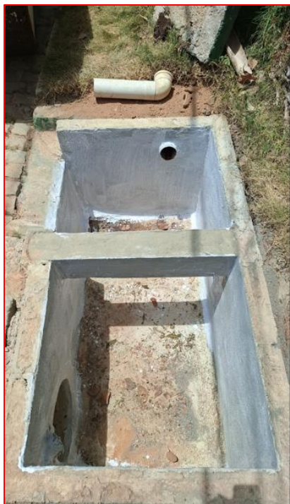
CAIXA DE DRENAGEM
